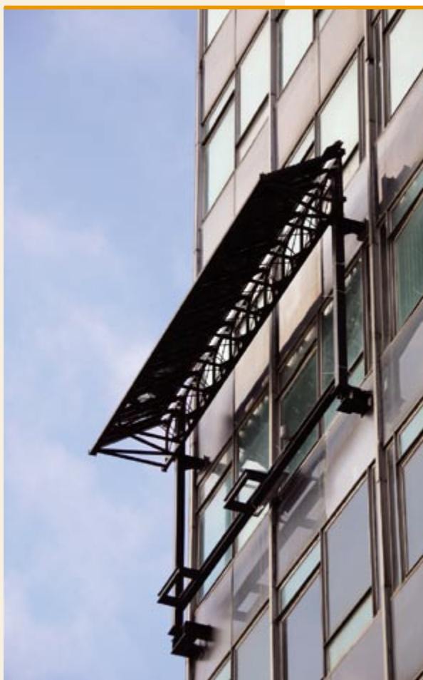
Fotowoltaiczne nadwieszenie zacięniającej na budynku C-7
