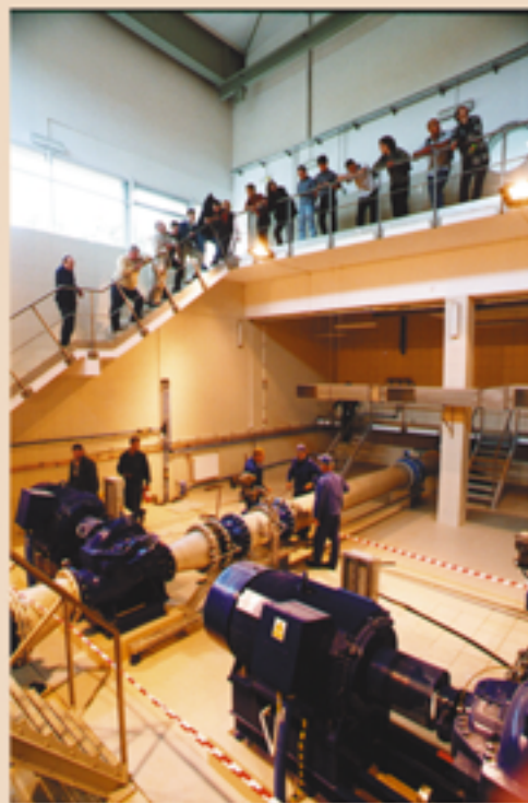
Nowa pompownia wody czystej (otwarta w br.)
